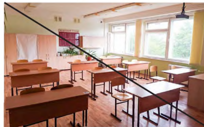
Плохо Линолеум под дерево
